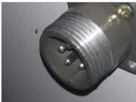
(base de conexão sob o quadro elétrico)
