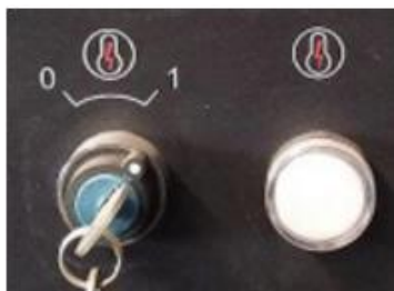
CHAVE SELETORA DE ENERGIA E LÂMPADA INDICADORA DE ENERGIA
