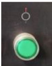
BOTÃO VERDE DE PARTIDA DA BOMBA HIDRÁULICA
